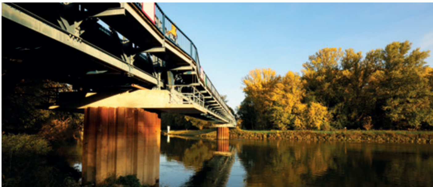
Hohenau an der March: Die einzige und einspurige Autobrücke zwischen der Slowakei und dem Weinviertel.
