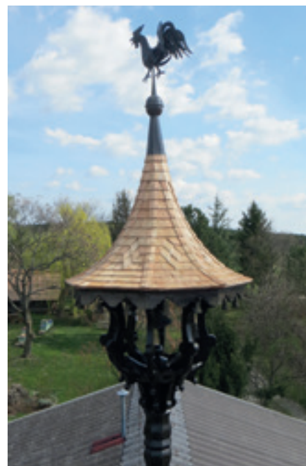
Wetterbahn am Schindelkegeldach. Foto: z. V. g.
